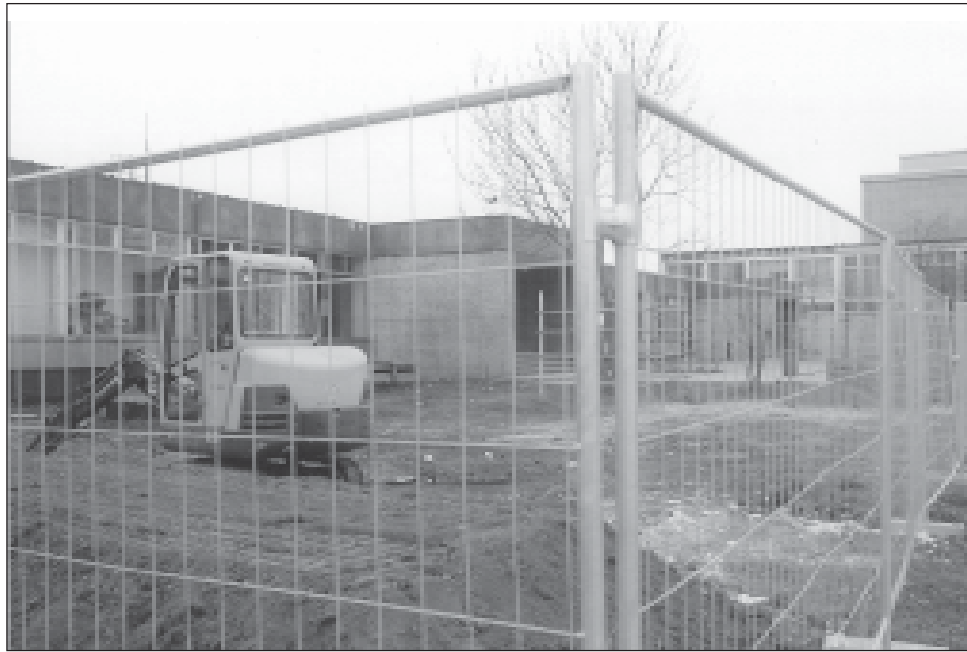
Blick durch den Zaun: Der Zugang zum Gebäude 130 ist zurzeit verwehrt. Zum Beginn des kommenden Herbstsemesters finden hier wieder Lehrveranstaltungen statt. Foto: Olaf Riedel
